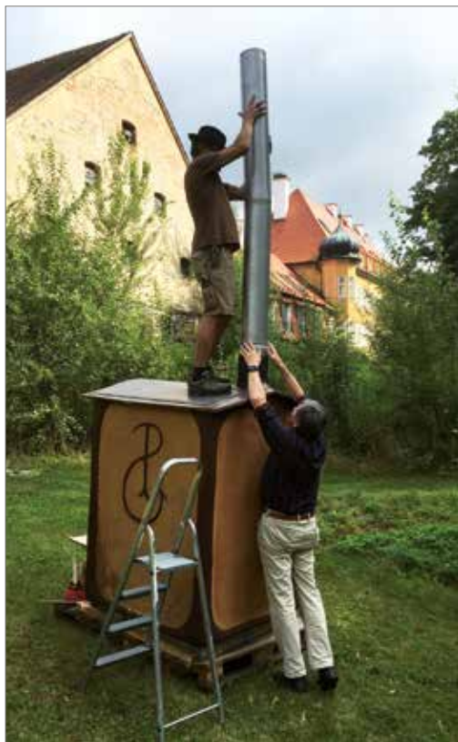
Unser neuer Brotbackofen wird aufgebaut! Karl und PG in voller Aktion – der Ofen wird von allen für Brot und Pizza heiß erwartet.
